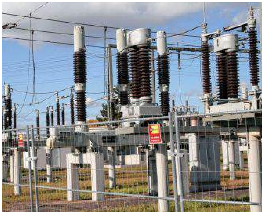
5.3.1.1-сурет. Ток трансформаторлары
